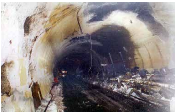
Slika 1. Tunel Mont Blanc nakon požara 6
